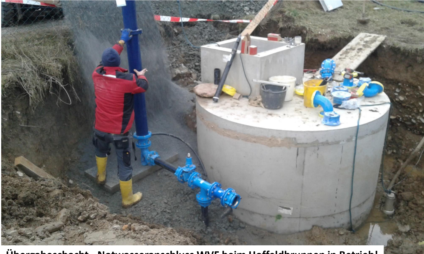
Übergabeschacht - Notwasseranschluss WVF beim Hoffeldbrunnen in Betrieb!
